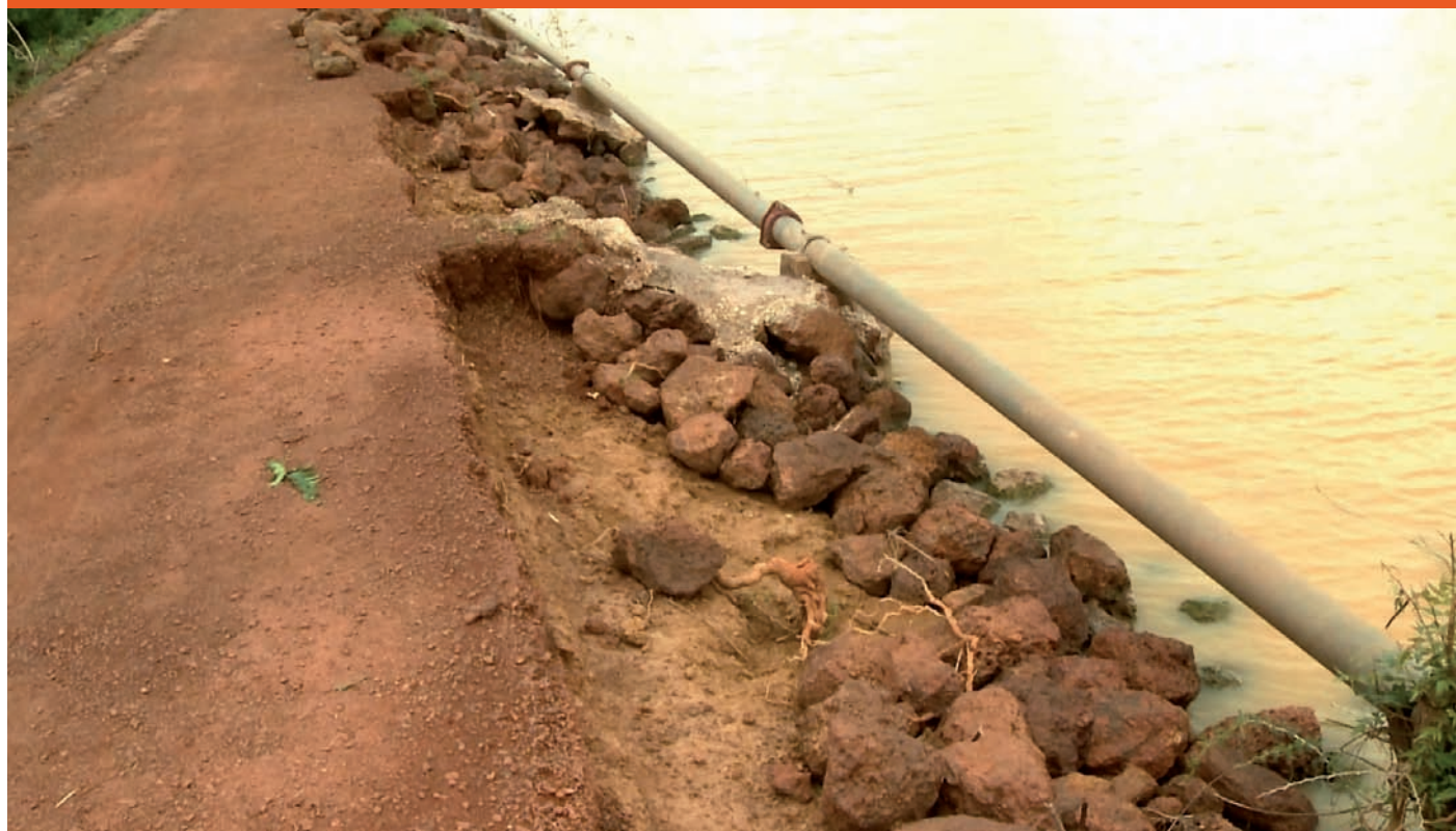
Etat de dégradation de la digue du barrage P.2
